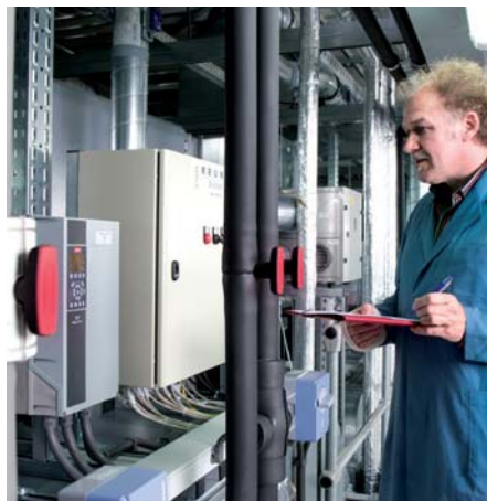
Ständige Überwachung der Lüftungstechnik
