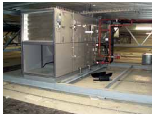
Op zolder staan 18 luchtbehandelingskasten voor conditionering van de lucht in de diverse ruimten
